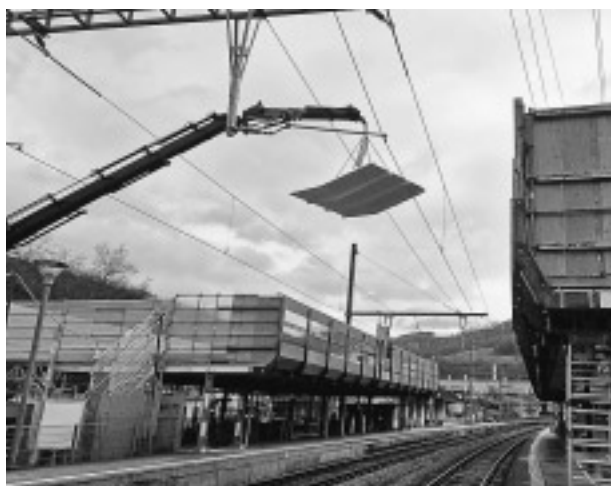
Ein Teil des neuen Perrondachs wird in Grellingen über die Fahrleitung gehoben.
